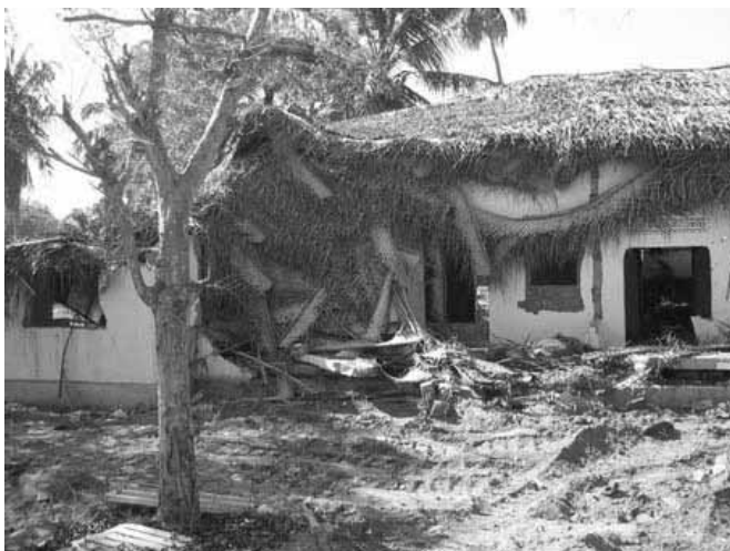
Zerstörtes Haus in Mullaittivu
